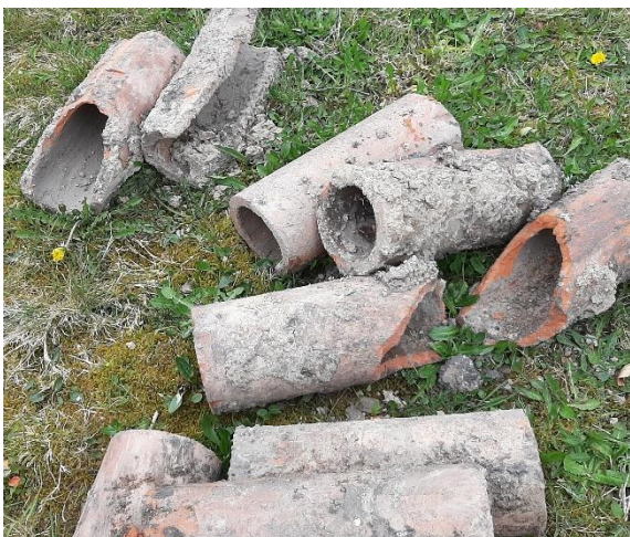
Sådan ser gamle, defekte drænrør ud.
